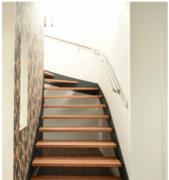
Der ergonomische Rundhandlauf an den Wänden folgt dem Wangenverlauf und gibt sicheren Halt beim Treppensteigen.
